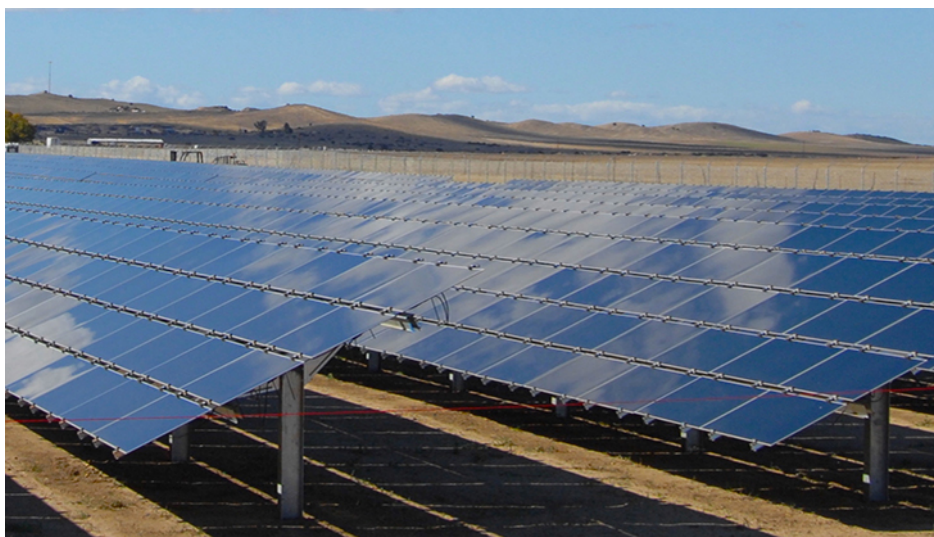
ILUSTRACJA 8.16 Instalacje ogniw fotowoltaicznych w skali przemysłowej są budowane w rejonach świata o dużym nasłonecznieniu po to, by wytwarzać energię elektryczną. (Źródło: Sarah Swenty)
